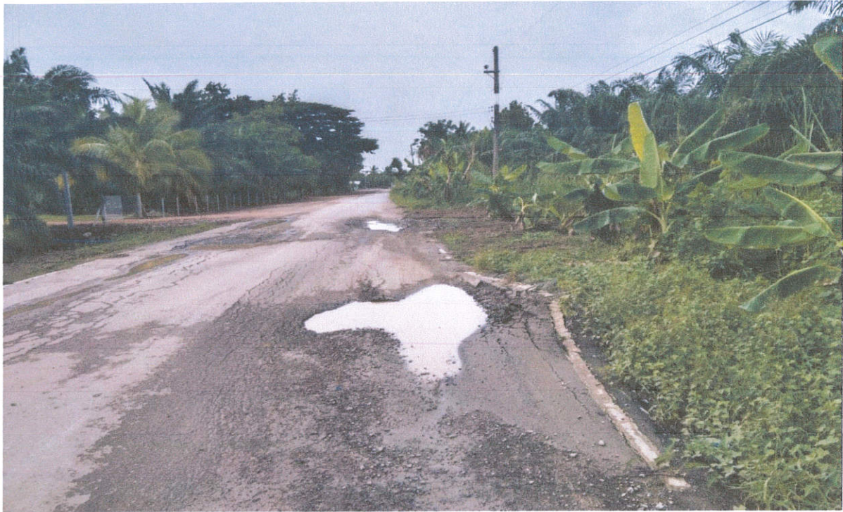
ภาพถ่ายสภาพปัจจุบัน ถนนสายหนองจระเข้ – เขตตำบลบ้านราม
