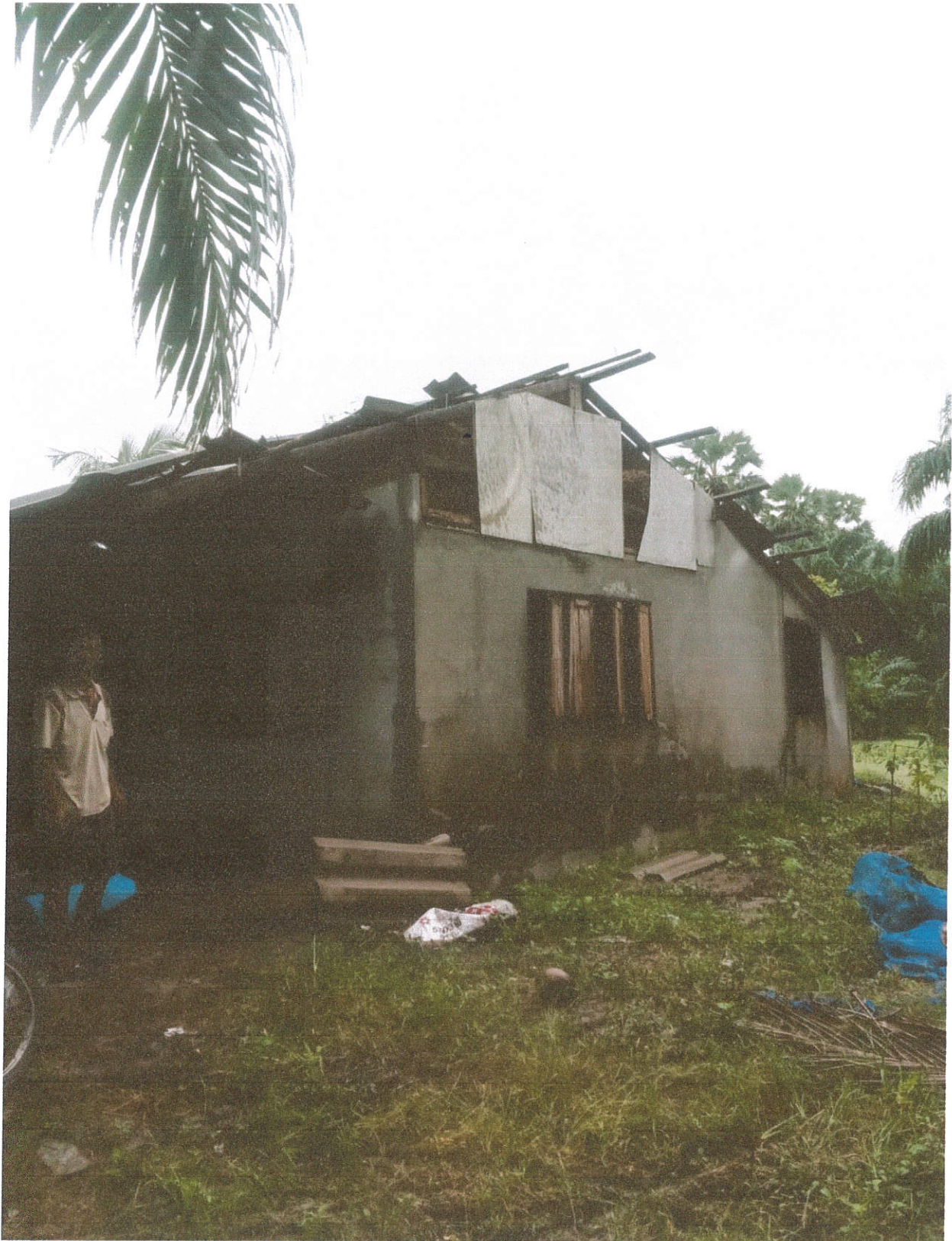
บ้านพักอาศัยที่ได้รับความเสียหาย (นางจีรภา เพชรคงแก้ว)
