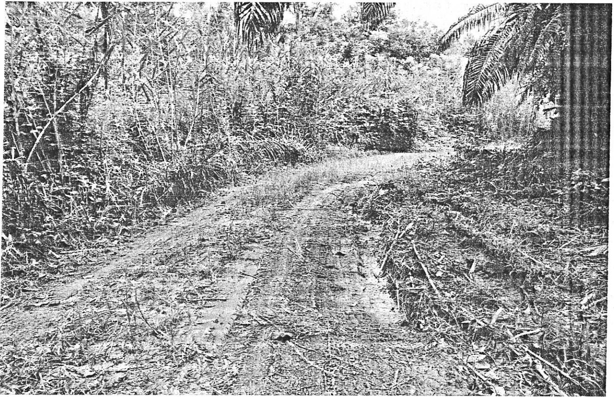
ภาพถ่ายสภาพปัจจุบัน (ถนนสายนายใจ หมู่ที่ ๖)
