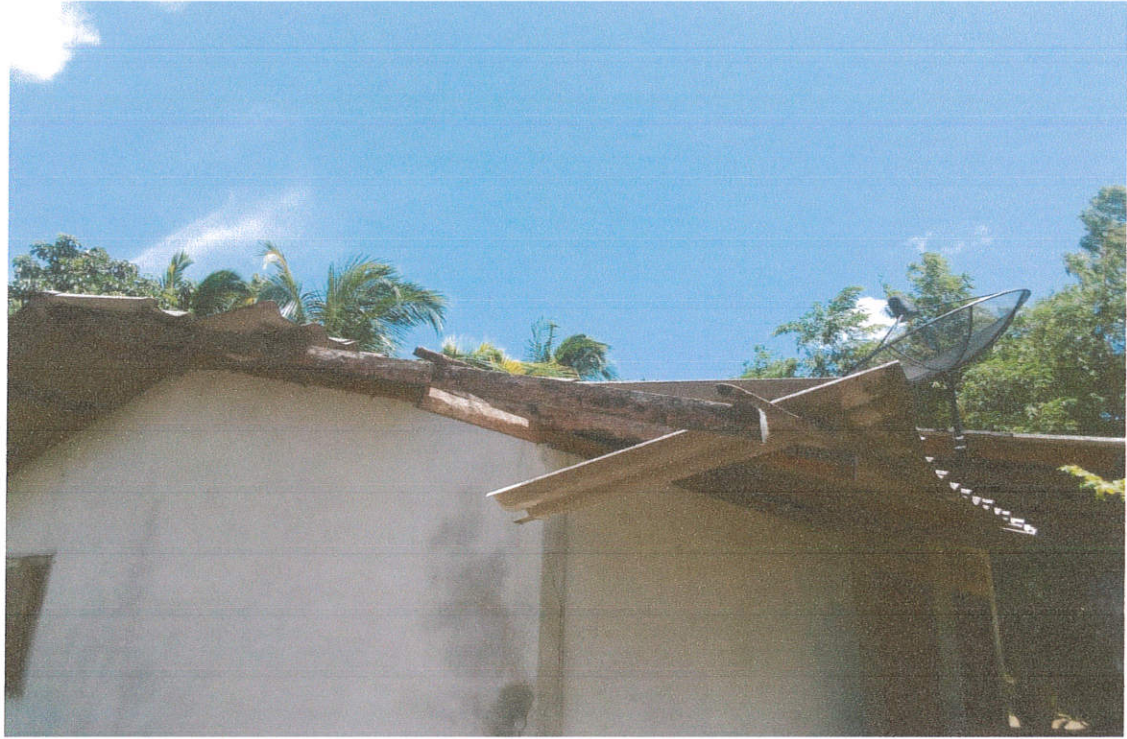
ภาพถ่ายบ้านเรือนได้รับความเสียหาย (นางฐิตาภา เต็มสิริมงคล)
