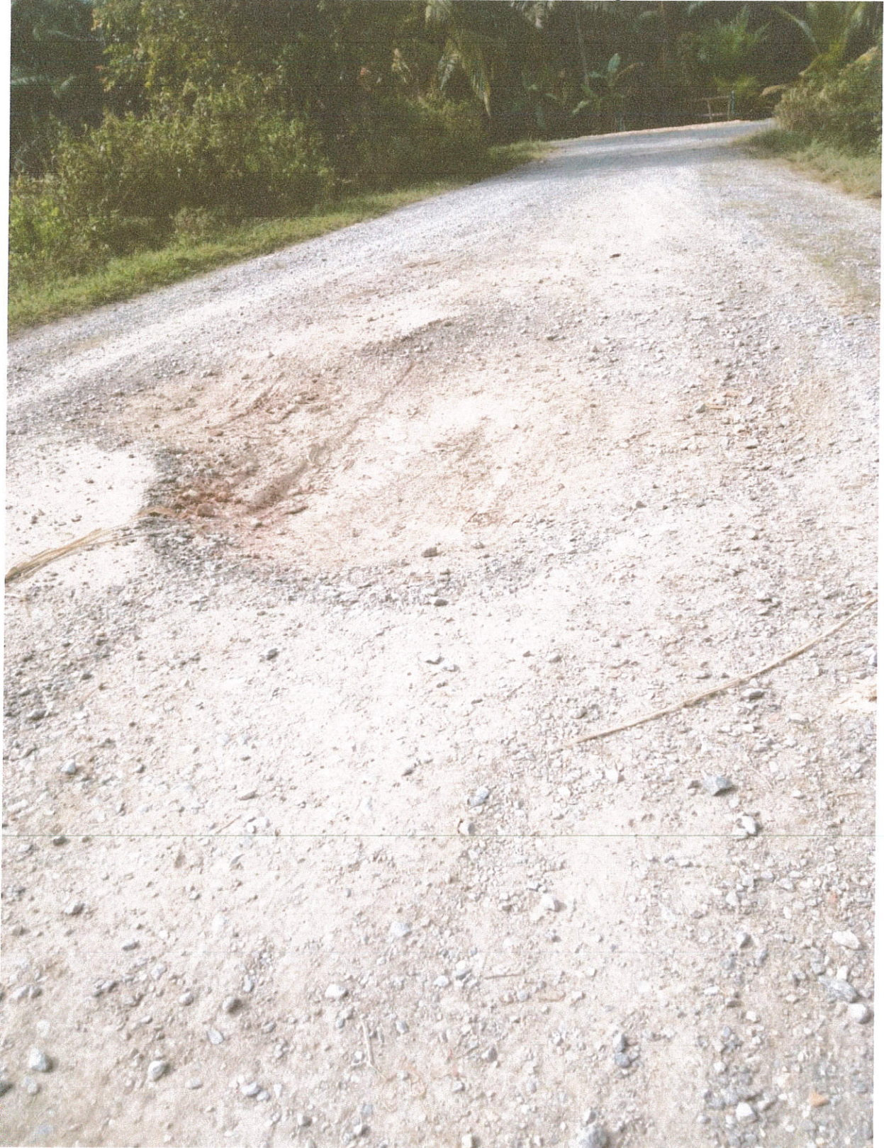
ภาพถ่ายสภาพปัจจุบันถนนสายบ้านดอนหัน หมู่ที่ ๓
